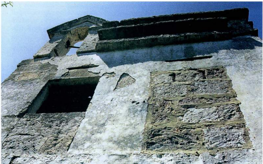
4 - Resti di un casale in zona Arco Camerata (foto E. Varrichio)
